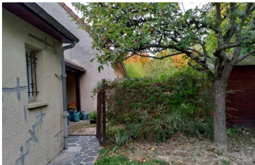
Fig. 21: Maison sinistrée par le RGA déclenché par la proximité de l'arbre (photographie prise en octobre 2022 en Essonne)
