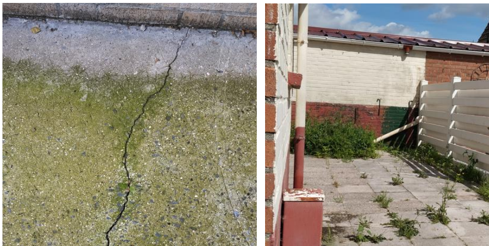
Fig. 85: Exemples rencontrés sur le terrain de défauts d'imperméabilisation (photographies prises en août 2024- Maisnil-lès-Ruitz)
