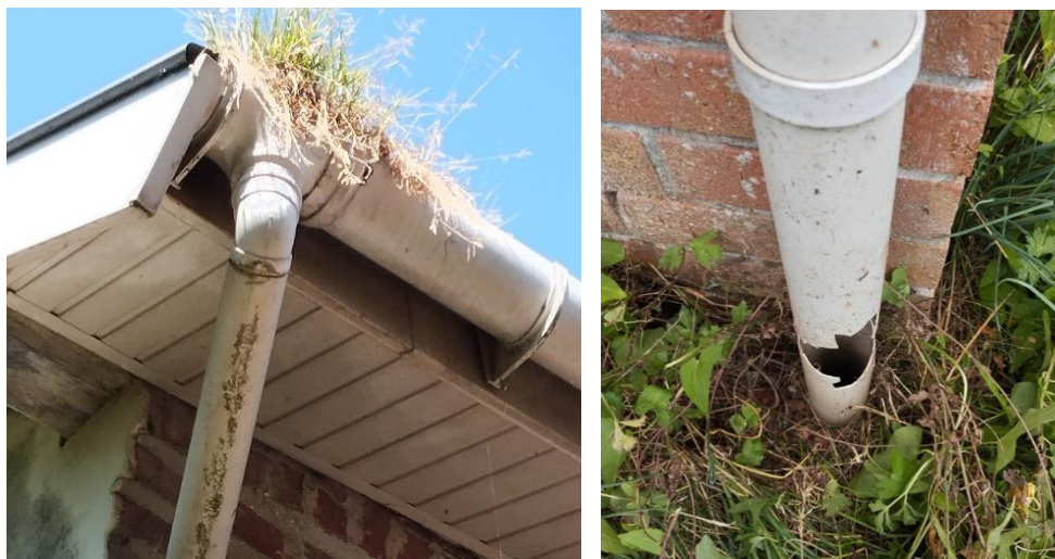
Fig. 88: Exemples rencontrés sur le terrain de gouttières endommagées (photographies prises en août 2024 - Carvin )
