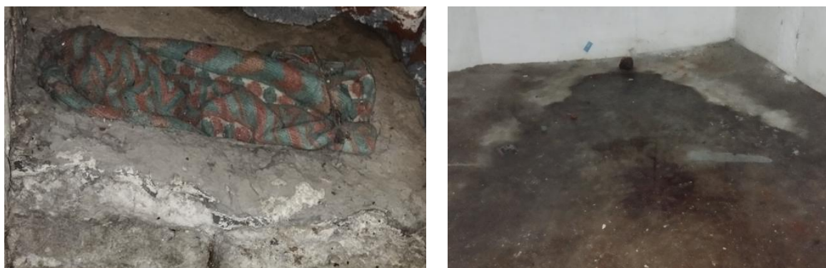
Fig. 91: Exemples rencontrés d'aération obstruée et d'humidité dans les sous-sols diagnostiqués (photographies prises en août 2024 - Courrières )
